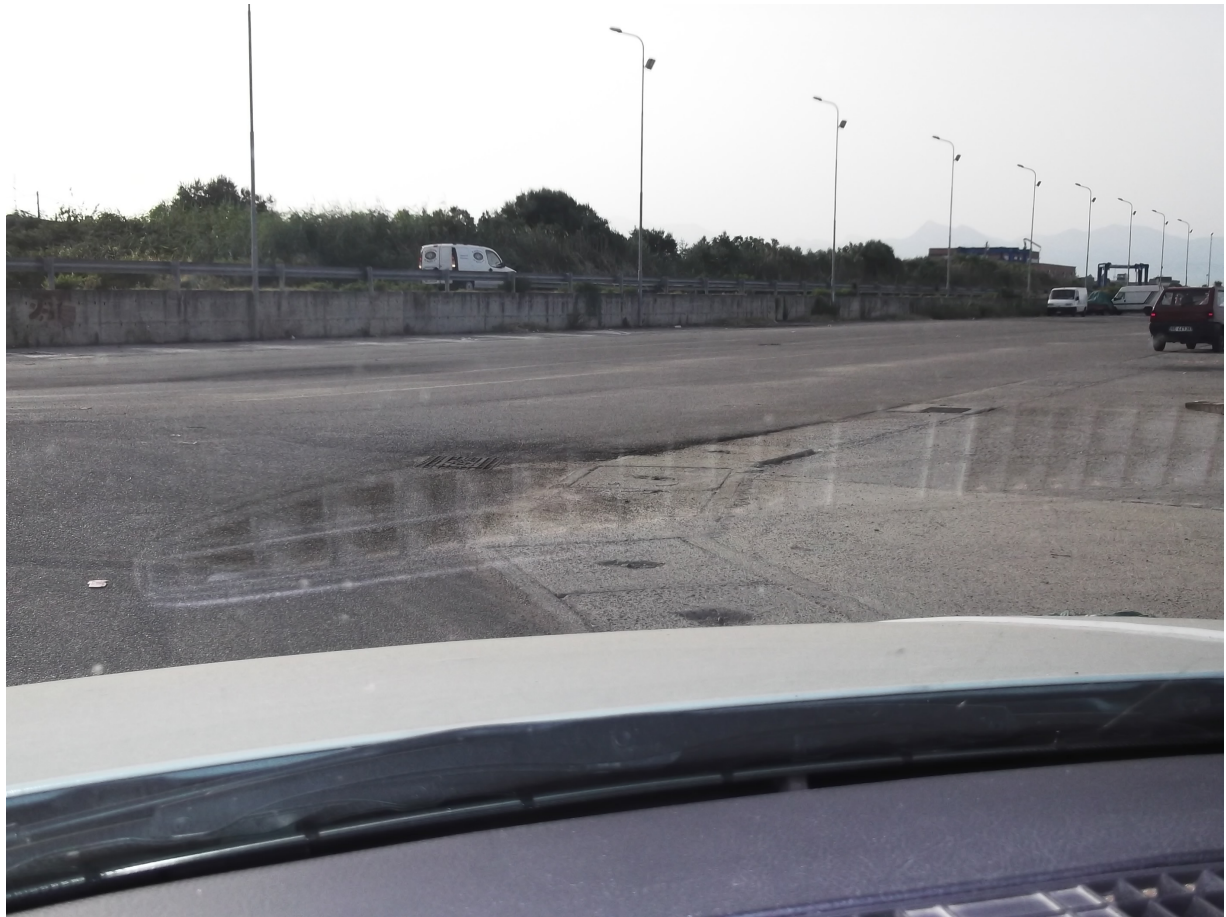
Rete idrica cunicolo esistente – foto 3
