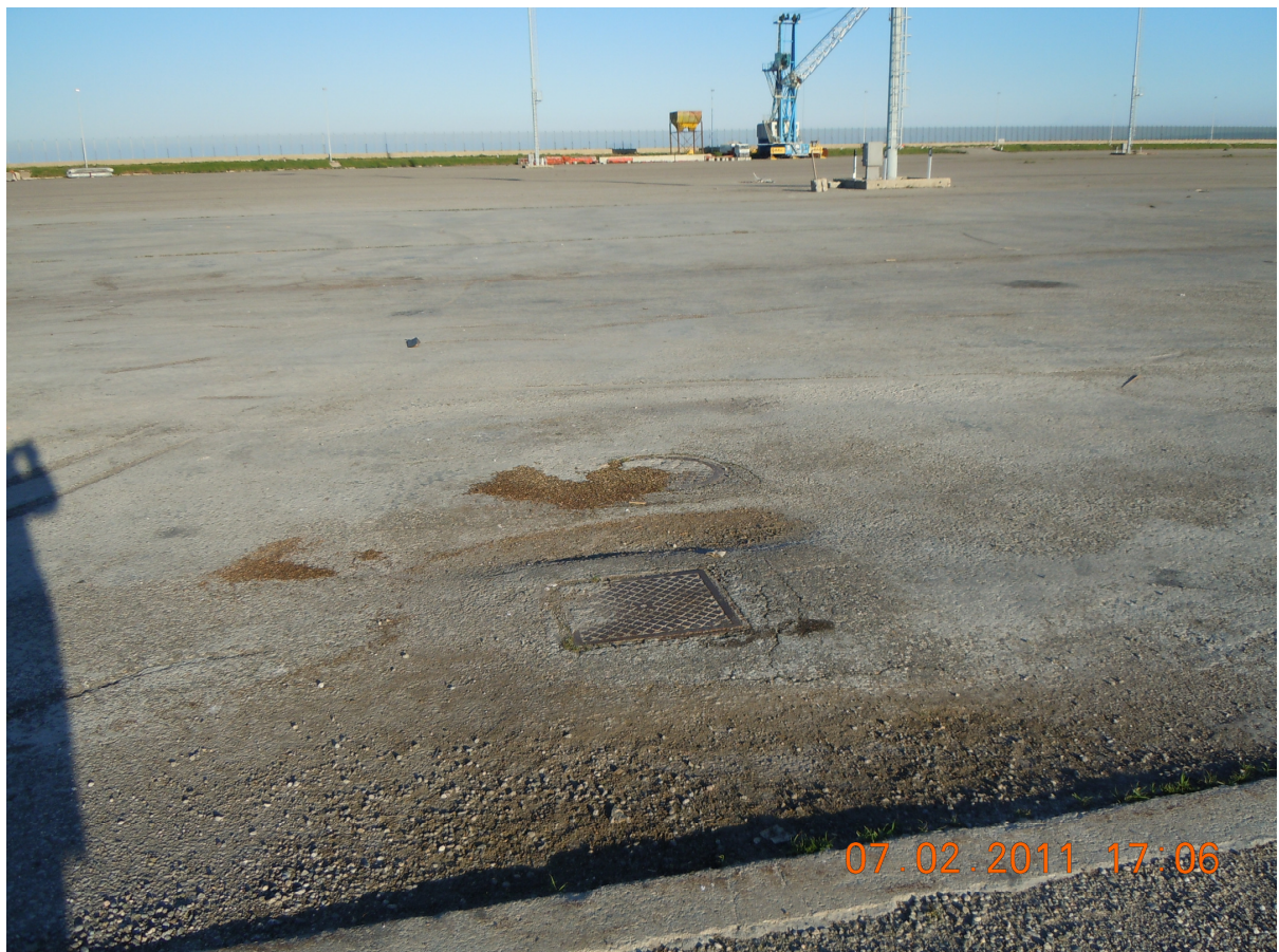
Rete idrica pozzetti esistenti – foto 4
