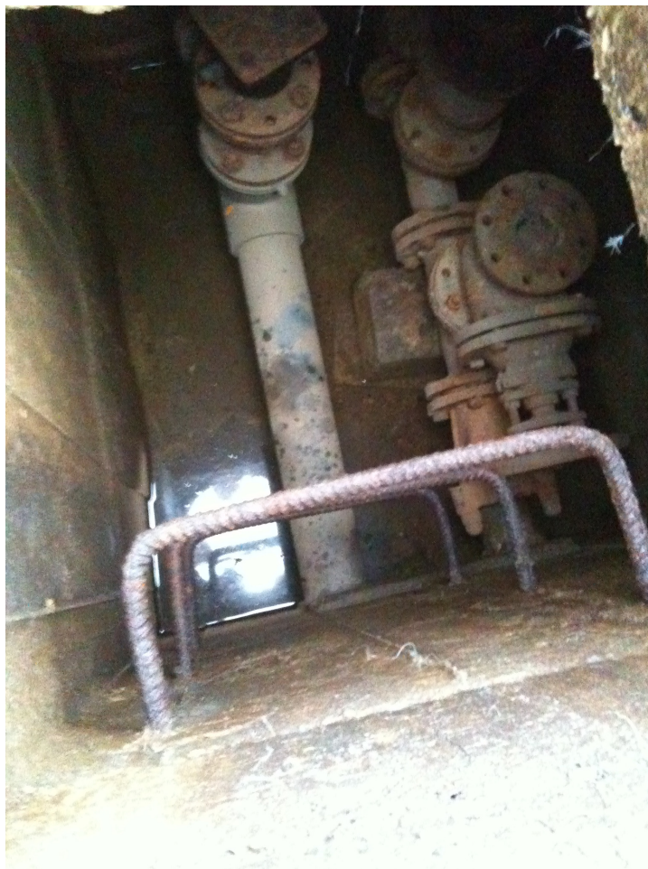
Rete antincendio - pozzetto esistente – foto 1
